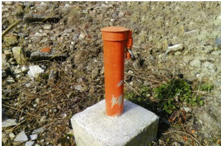
Photo 13 : Vue d'une tête de piézomètre cadenassé avec massif scellé
